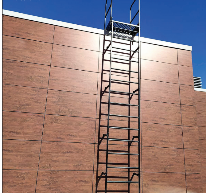
Рис. 26. Лестница пожарная на объекте
